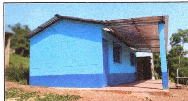
Foto 6: Piso de concreto y correctivo en paredes del establecimiento.
